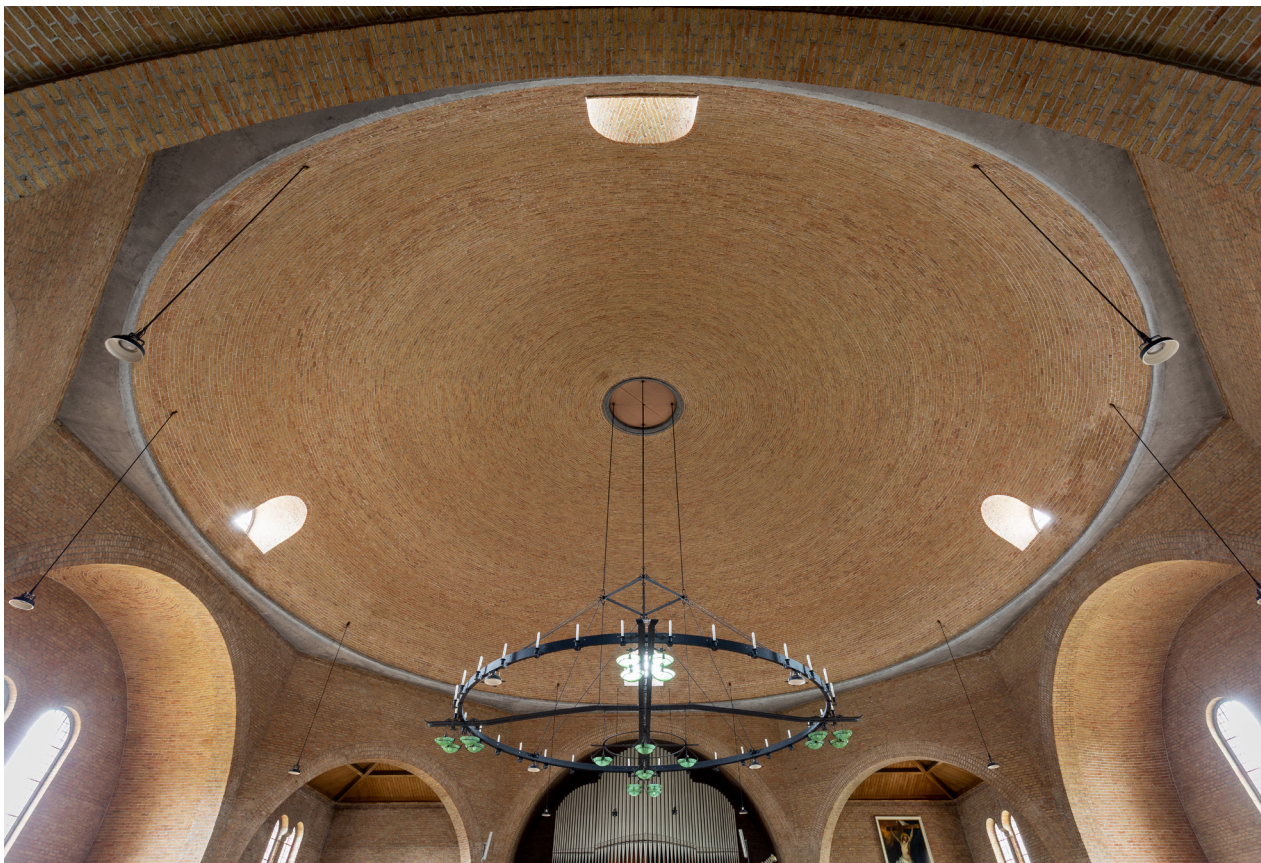
Het ambachtelijk gemetselde koepelgewelf steunt op een betonnen ring die de druk overbrengt op de onderbouw, een vernieuwend principe in die tijd.
